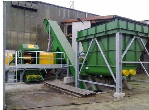
Abbildung 7. Leistungsfähigere und überarbeitete Anlage in Mecklenburg-Vorpommern
